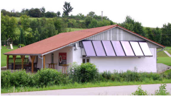
Abb. 5: Geförderte Solaranlage des TSV Hofkirchen
